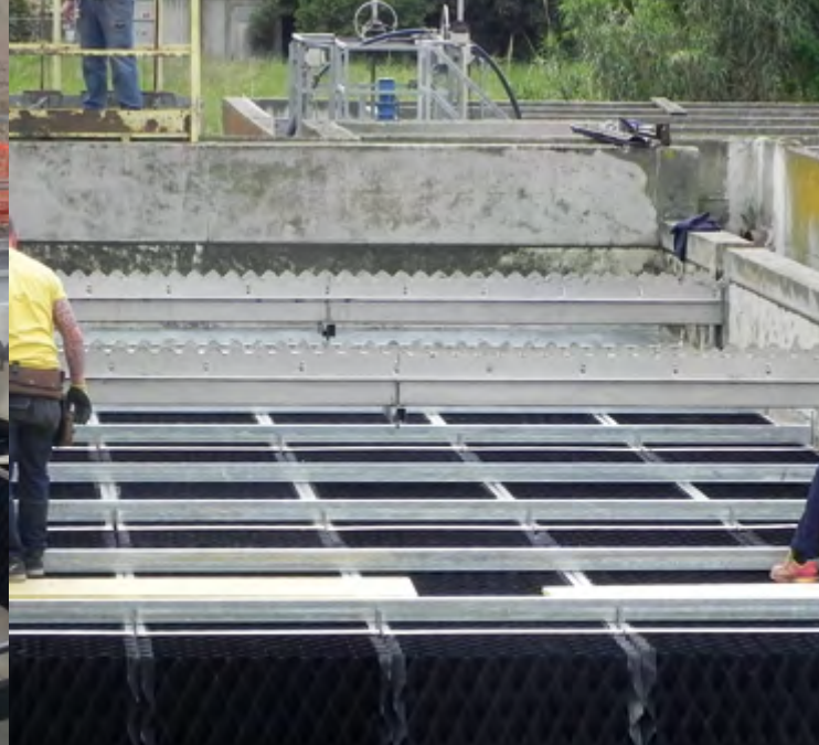
Sedimentatore secondario con LSM60 (MC) Final clarifier with LSM60 (Massa Carrara - Italy)
