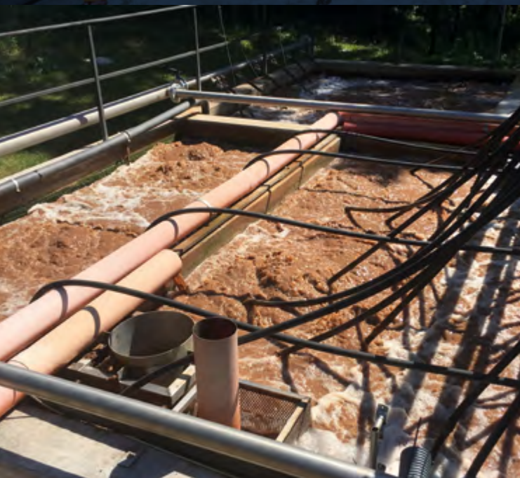
Impianto MBBR per settore birrario con SAGM (PU) MBBR Plant for brewing industry with SAGM (Pesaro Urbino - Italy)
