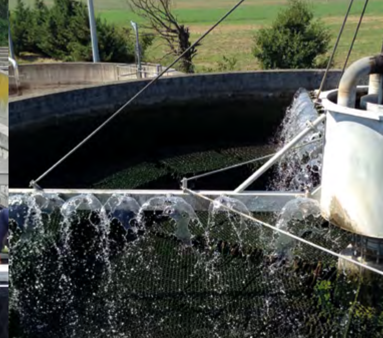
Percolatore per settore alimentare con moduli TFM27 (PR) Trickling filter for food industry with TFM27 modules (Parma - Italy)
